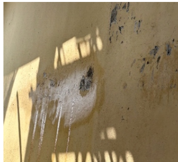
Tường bị thấm từ nhà vệ sinh
