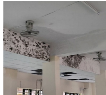
Sàn bê tông bị nứt dẫn đến thấm
